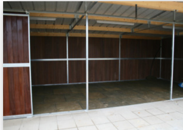
Offenstall mit Drainoflex-Drainage-Stallboden
